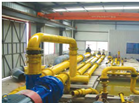
▲ 喷嘴测试泵站
